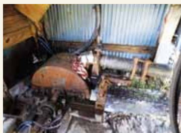
小水力の一例(約3kW)
